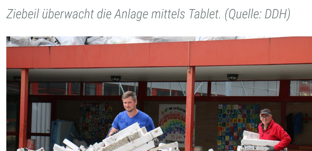
Die Mitarbeiter befüllen die Anlage mit den bitumenbefreiten EPS-Abschnitten der Klappbahn. (Quelle: DDH)
